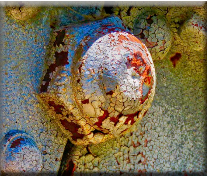
Rusted Bolt Em McLaren
